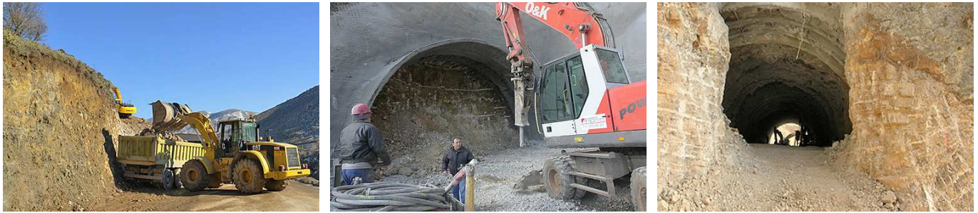
Im März und April 2008 begann man auf der Gegenseite des Tunnels aufeinander zu zuarbeiten um einen Durchbruch zu erzielen; Abb. re.: der Durchbruch ist geschafft.
